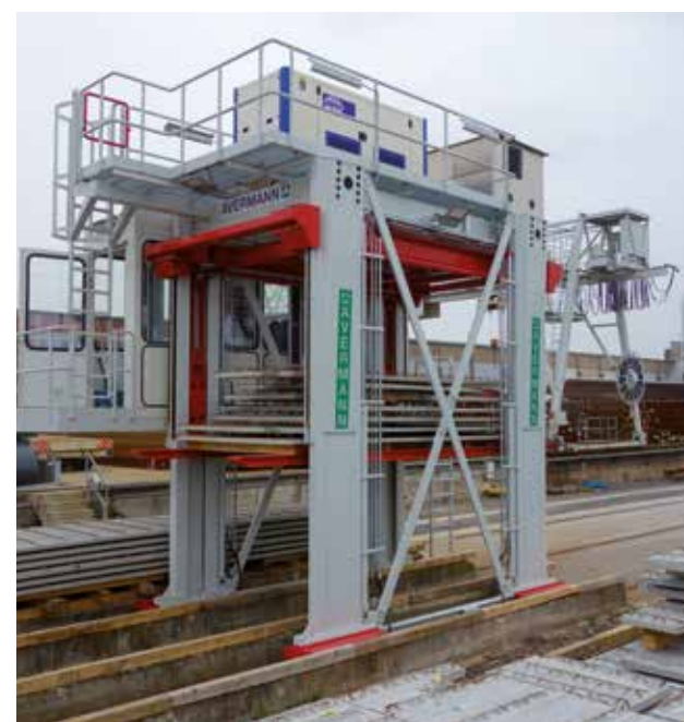
Echipament de încărcare pentru stive de plafoane prefabricate
